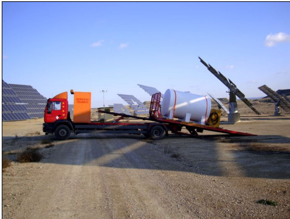
Figura 5. Deposito de alta capacidad
